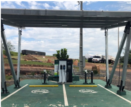
Fig.74- Punto de carga de vehículo eléctrico
